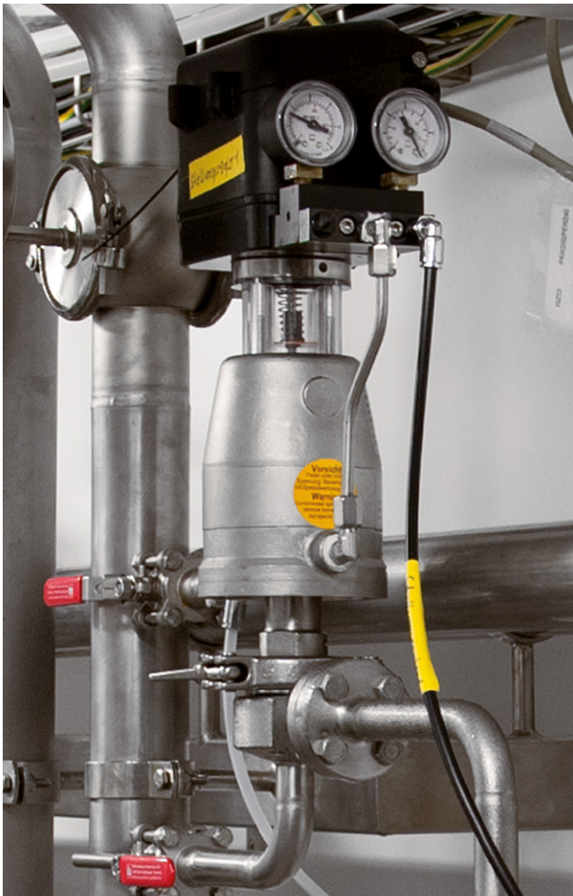
Abb. 2 Das Eckventil der Baureihe 6000 von Schubert & Salzer Control Systems in der Wiesn-Container-Anlage von Paulaner.
