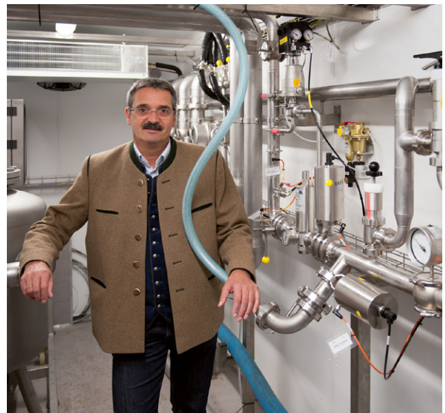
Abb. 1 Uwe Daebel, Hauptabteilungsleiter Abfüll- und Verpackungstechnik bei Paulaner, hatte die Idee der Konstantdruckhaltung und war von der Druckhaltepräzision des Hygiene-Eckventils mit digitalem Stellungsregler 8049 begeistert.
