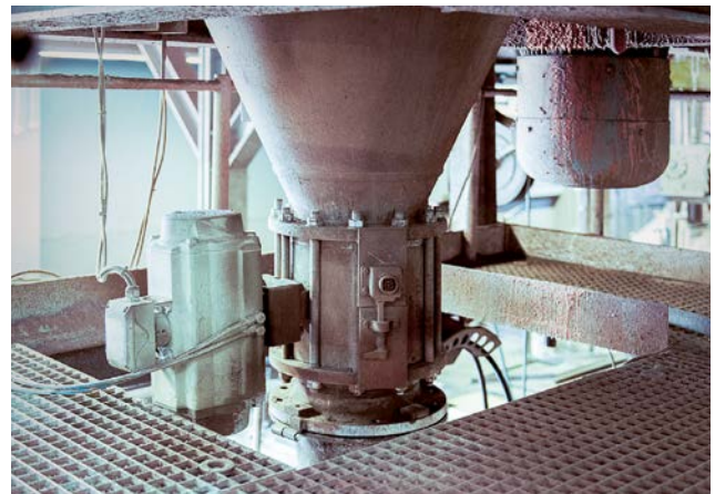
Abb. 4 Kugelsektorventil am Mischerbaum.
